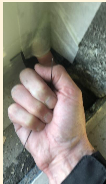
Gat í gegnum þéttingu að innan orsakar leka.
