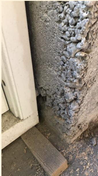
Búið að setja karm í án þess að laga skemmdir
