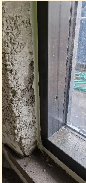
Steypuhreiður sem hefur ekki verið lagað
